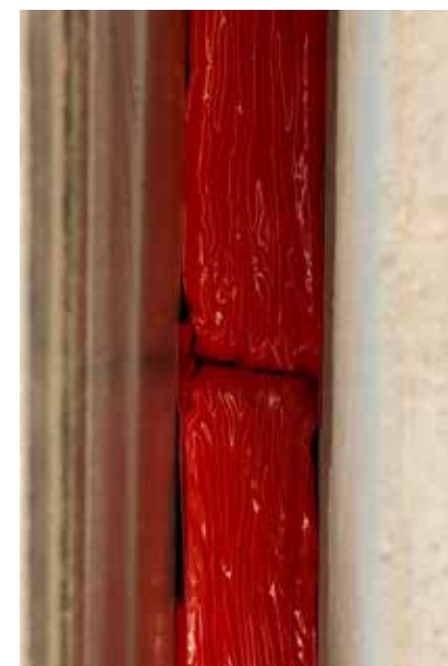
Na het lek prikken van de Firetight zet deze onmiddellijk uit en wordt de sparing tussen de gevel en het casco binnen enkele seconden dichtgezet.
